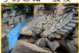
先日の大阪北部地震による高槻での被害
